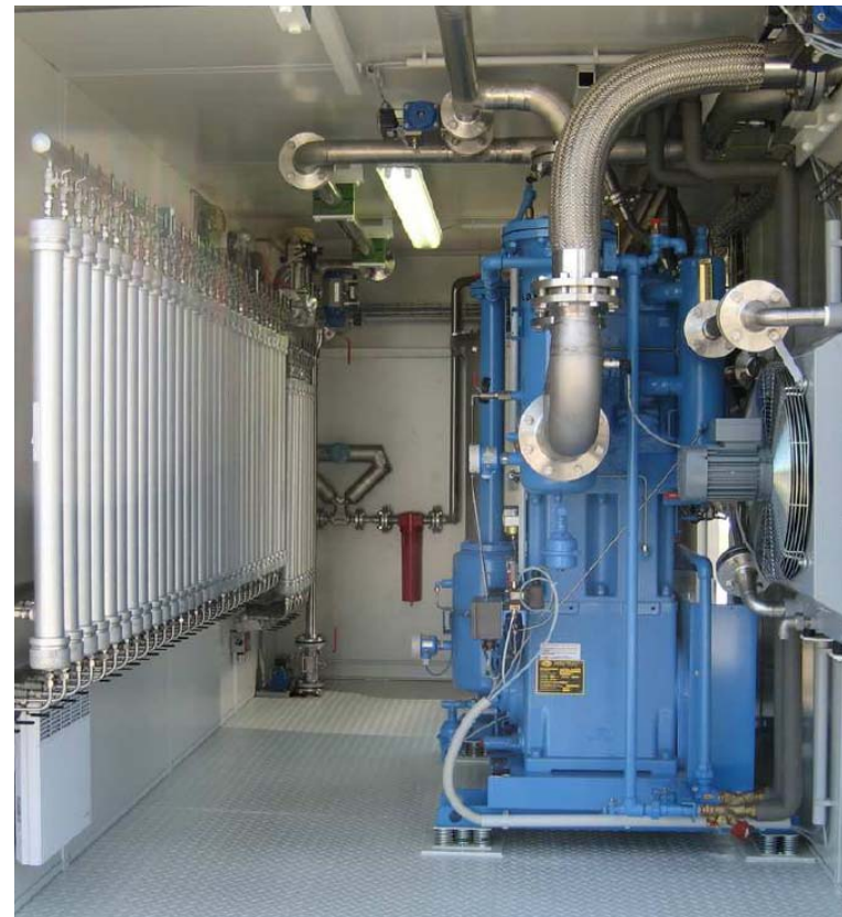
Quelle: Harasek, TU Wien, Membrananlage Bruck a. Leitha (A)
